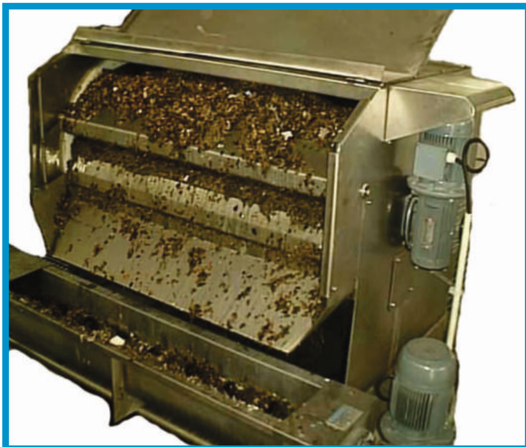
Fig. n°1 Tamiz rotativo mod. RFA 6100 funcionando
