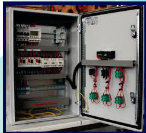
Cuadro de Control
